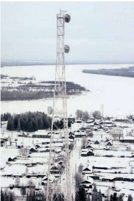
На десяти узловых станциях установлены новые антенно-мачтовые конструкции
