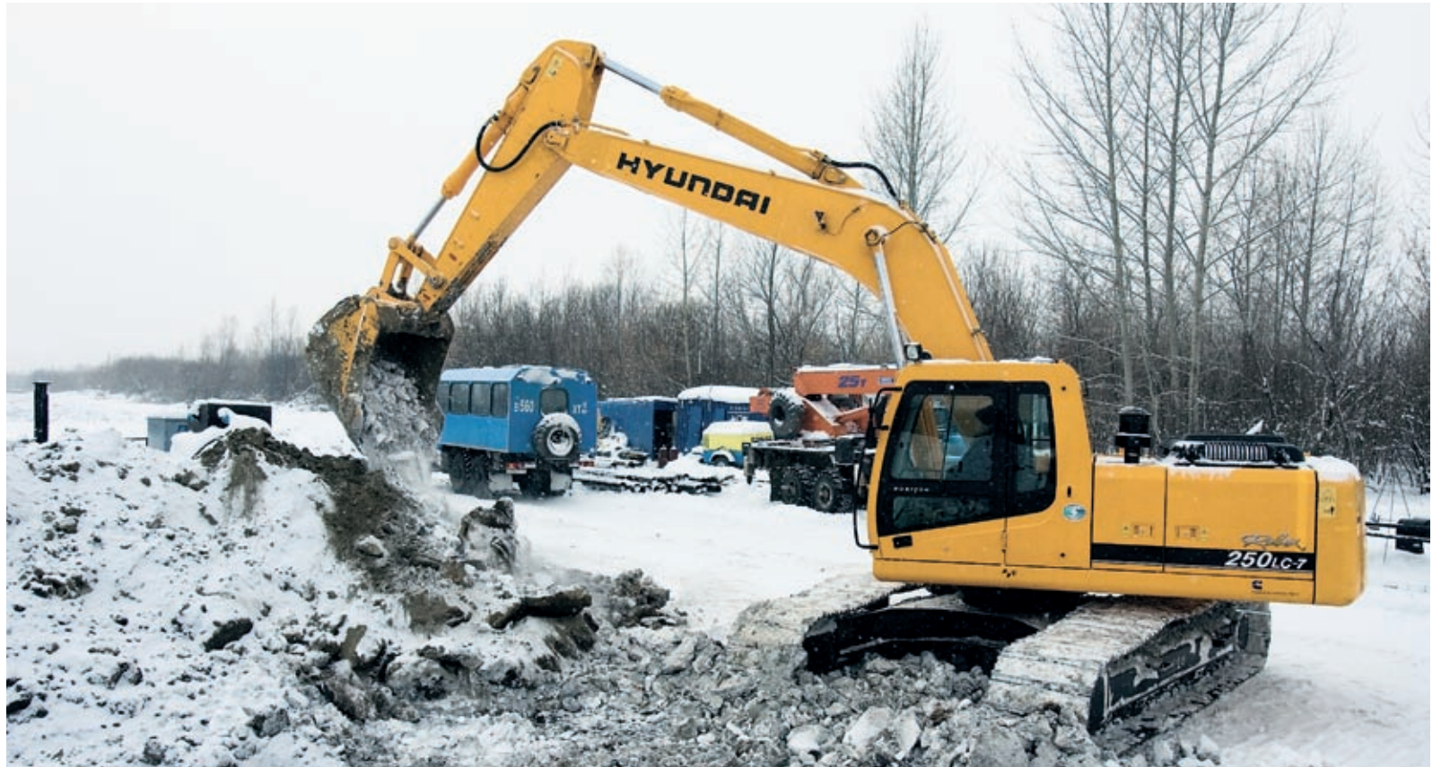
Строительство ГРС идет в селах Советском, Березовке и Усть-Ише. Идет подготовка фундаментов под ГРС и дома операторов. В ближайшее время начнется монтаж технологического оборудования
